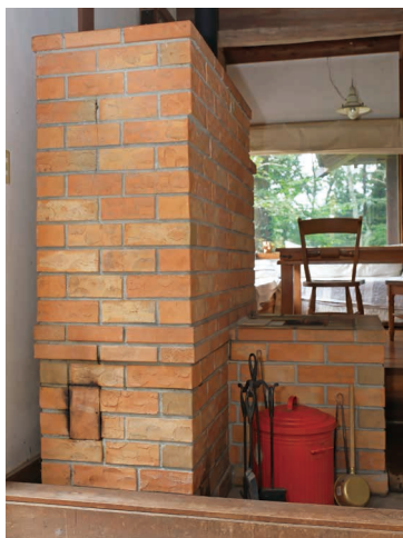
レンガ積みの大ぶりの燃烧ユニット。ヒートライザーを上昇した燃烧ガスは、一度燃烧ユニットの左側(写真の掃除口が見える面)を降下し、蓄熱ユニットの煙道へと進む
