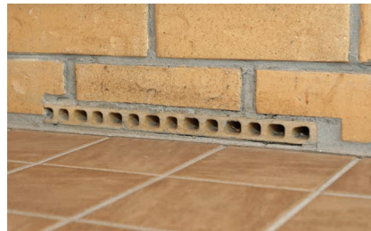
燃焼室の下部には穴あきの耐熱板を配し、給気を促している
